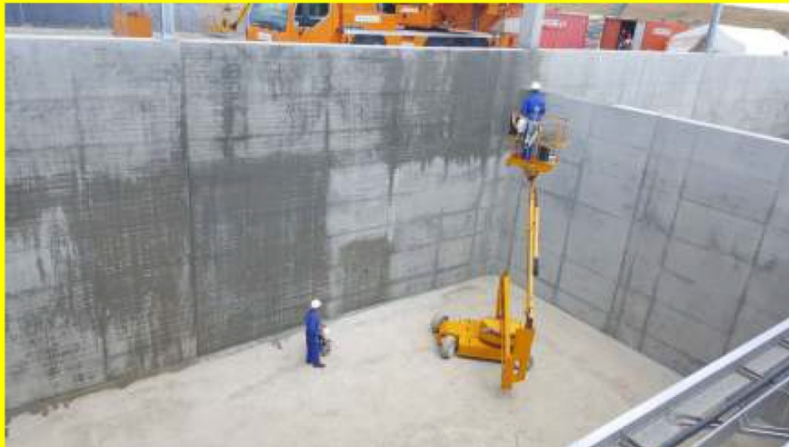
Tanques de sedimentación
