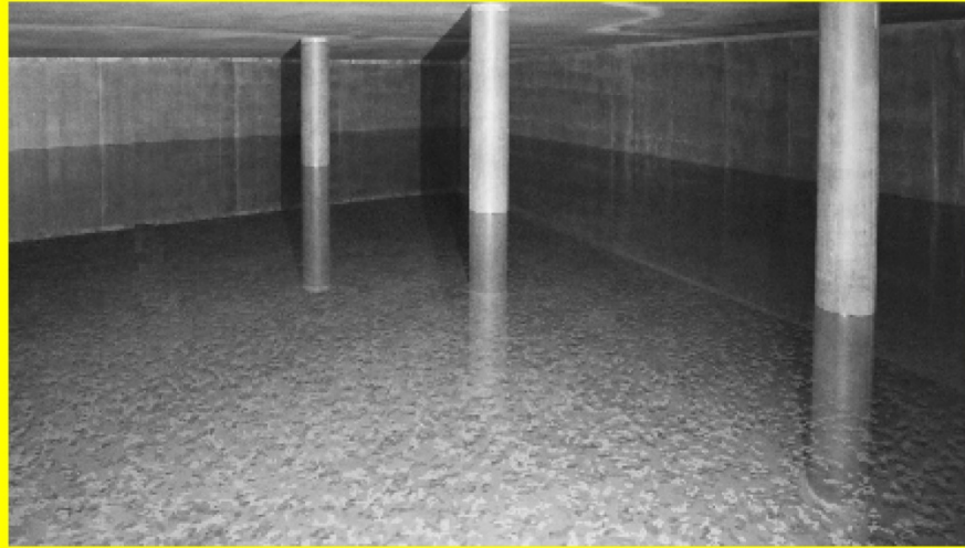
Depósitos de agua potable
