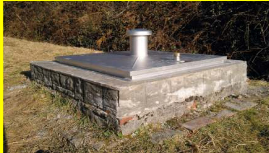
Pozos de recolección de aguas de manantial
